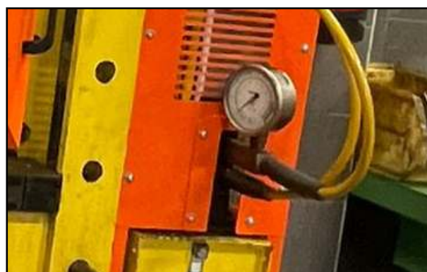
Ejemplo de acometidas en buen estado.
