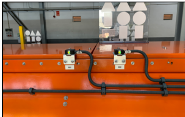
Ejemplo de aplicación de dispositivo de enclavamiento.
