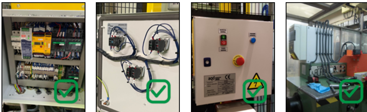
Ejemplos de armarios, botoneras y cableado en buen estado.
