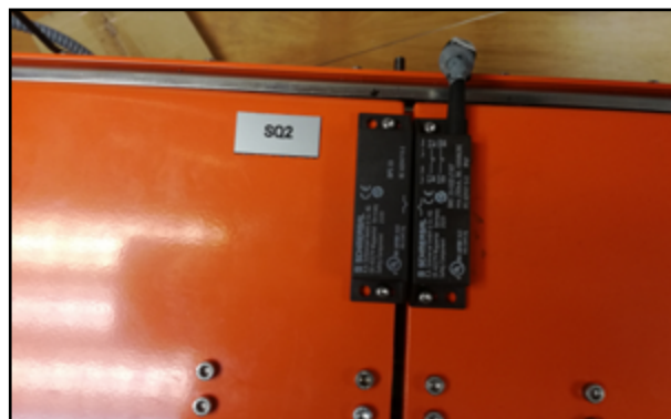
Dispositivo de enclavamiento en resguardo.
