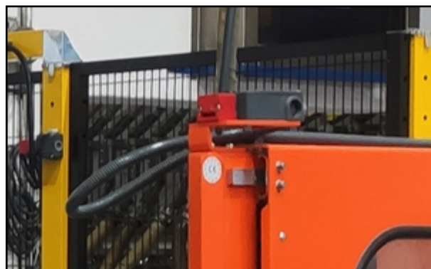
Dispositivo de enclavamiento en resguardo.
