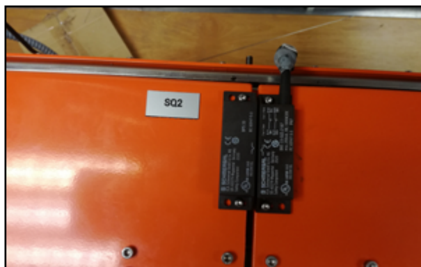
Ejemplo de aplicación de dispositivo de enclavamiento.
