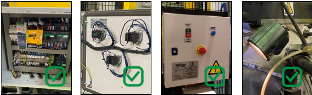
Ejemplos de armarios, botoneras e iluminación adecuados.
