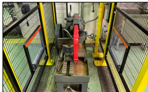
Ejemplo de protección con vallado con aberturas para el paso de material. Enlace a vallado de seguridad.
