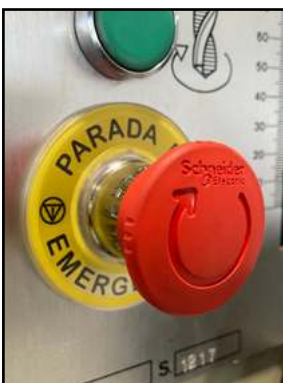
Parada de emergencia adecuada.
