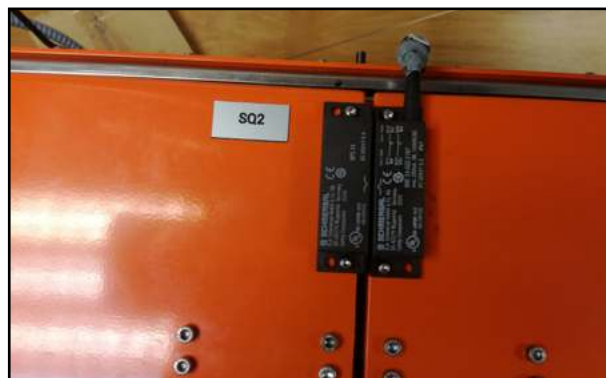
Dispositivo de enclavamiento en resguardo.
