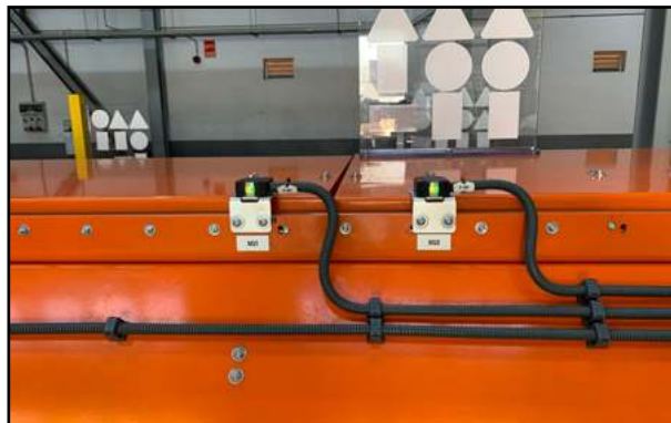
Ejemplo de aplicación de dispositivo de enclavamiento.
