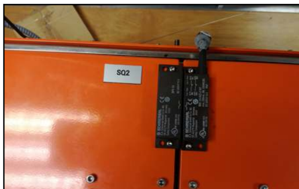
Ejemplo de aplicación de dispositivo de enclavamiento.
