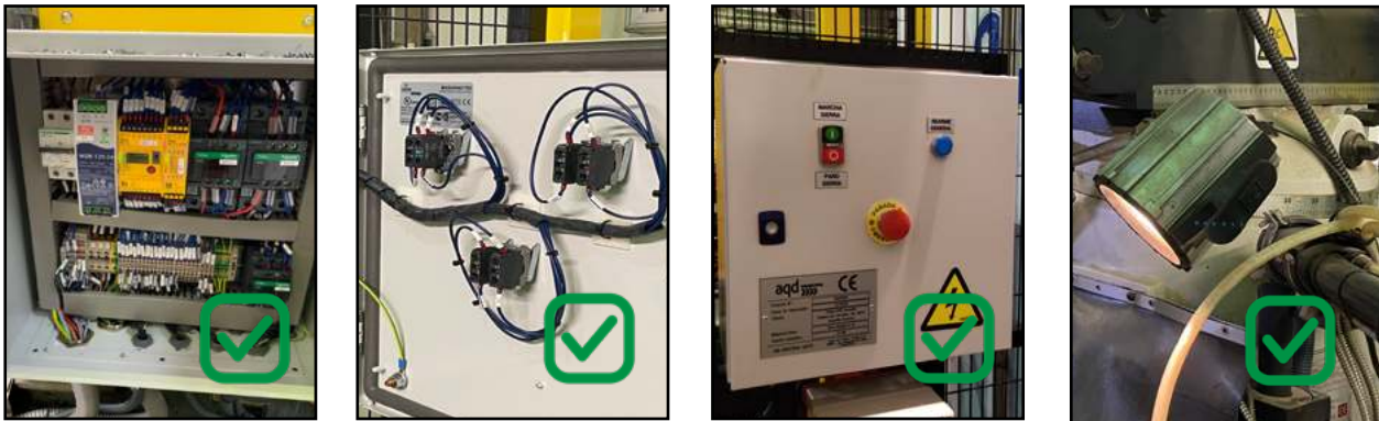
Ejemplos de armarios, botoneras e iluminación adecuados.
